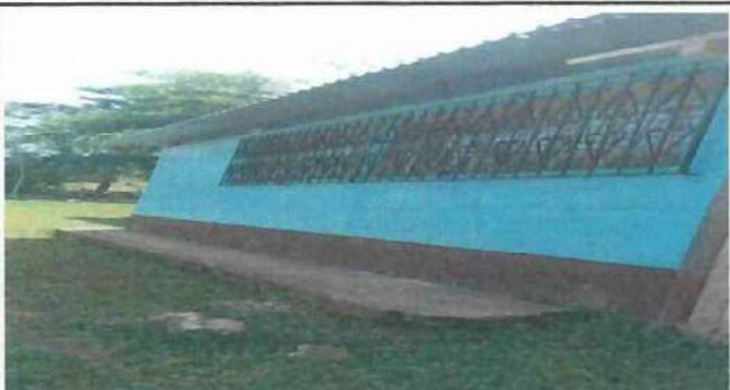
Foto 4: Se observa en la fotografía la necesidad de repello y pintura de la pared del edificio dos.
