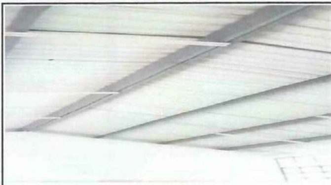
Foto 1: Se observa en la fotografía la falta de cielo falso de tres aulas y una dirección.
