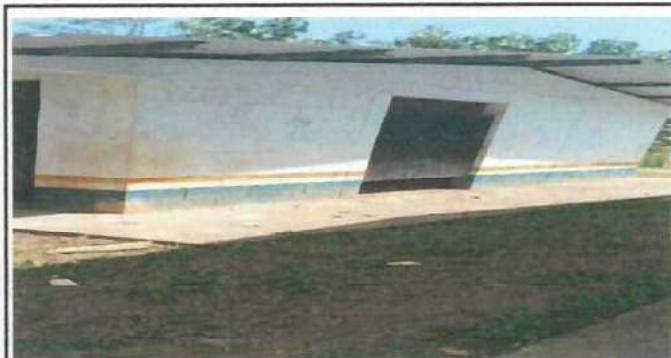
Foto 3: Se observa en la fotografía la necesidad de repello y pintura de la escuela del edificio uno.
