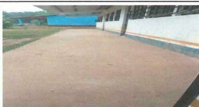
Foto 2: Se observa en la fotografía el deterioro del piso del corredor de la escuela.
